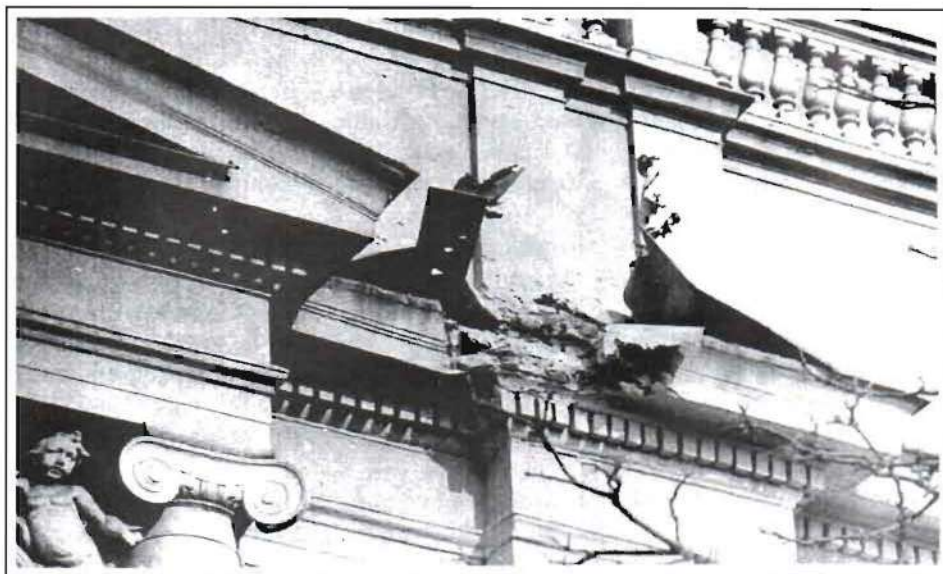
Oštećenje na južnoj strani fasade Arheološkog odjeljenja
